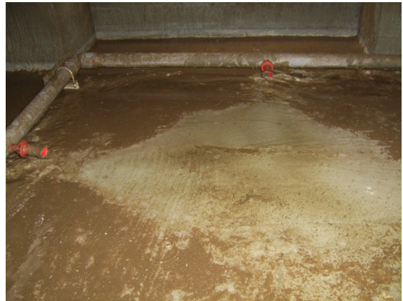
: TCS설치 1개월 후 냉각탑 수조 상태
