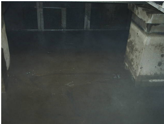
: TCS설치 전 냉각탑 수조 바닥 모습
